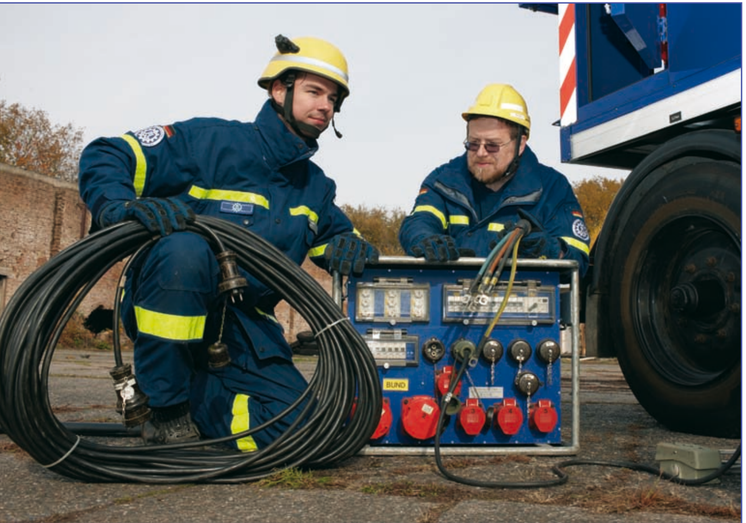
Vorbereitungen für den Einsatz des Stromverteilers
