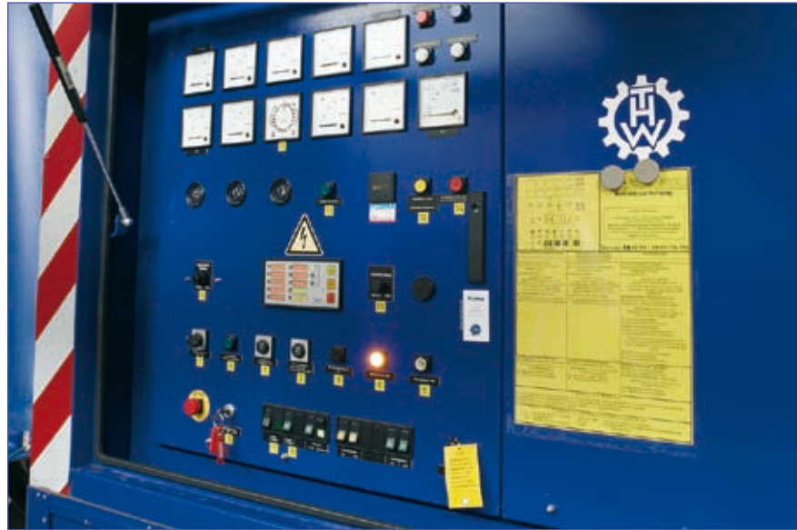
Ansicht der Netzersatzanlage 175 KVA
